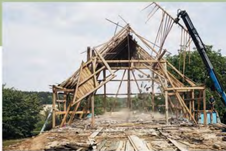
Krachender Erfolg: Sparren für Sparren zerflückt Florian Eckart (hinten rechts) den Dachstuhl im überfränk...
